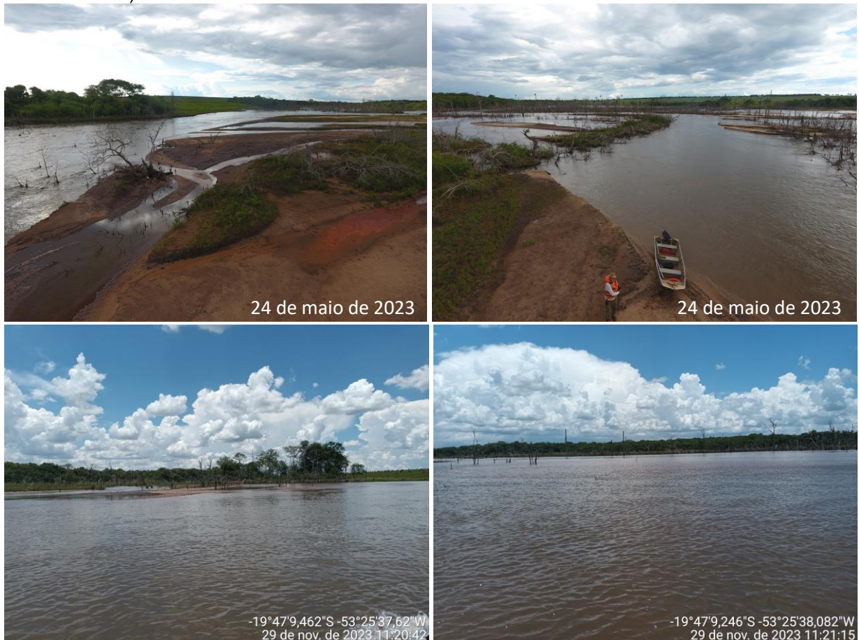
Figura 8 – Ponto 6: Erosão em sulcos com processo de assoreamento e formação de ilhas na área 1 da PCH Verde 4A, no município de Água Clara/MS. Campanhas de 2023 (Fotos 1 e 2 - maio, Fotos 3 e 4 - novembro).
