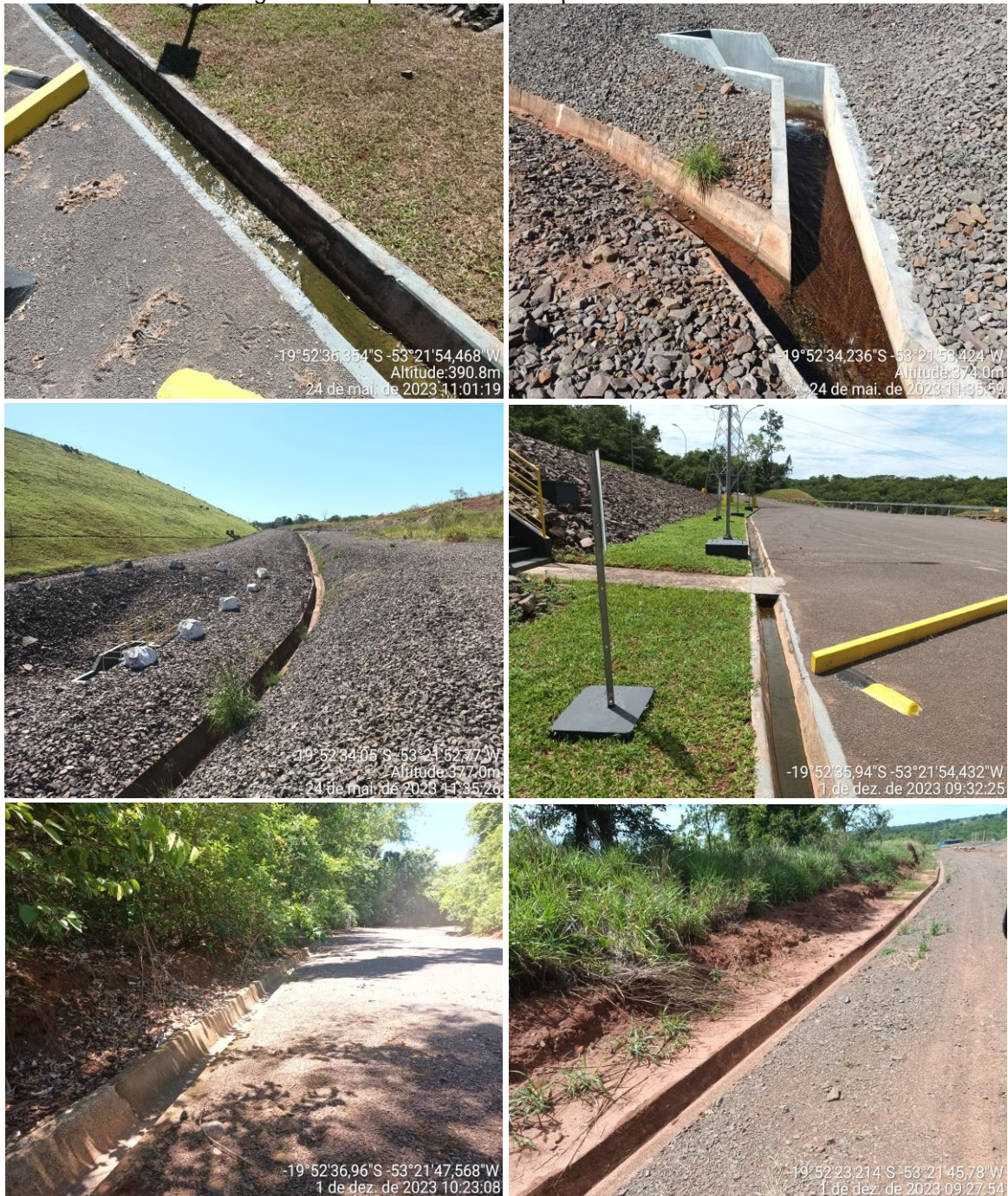
Figura 11 – Canaletas para escoamento de água nas vias de acesso da PCH Verde 4A, evidenciando medidas mitigatórias implementadas. Campanhas de 2023.
