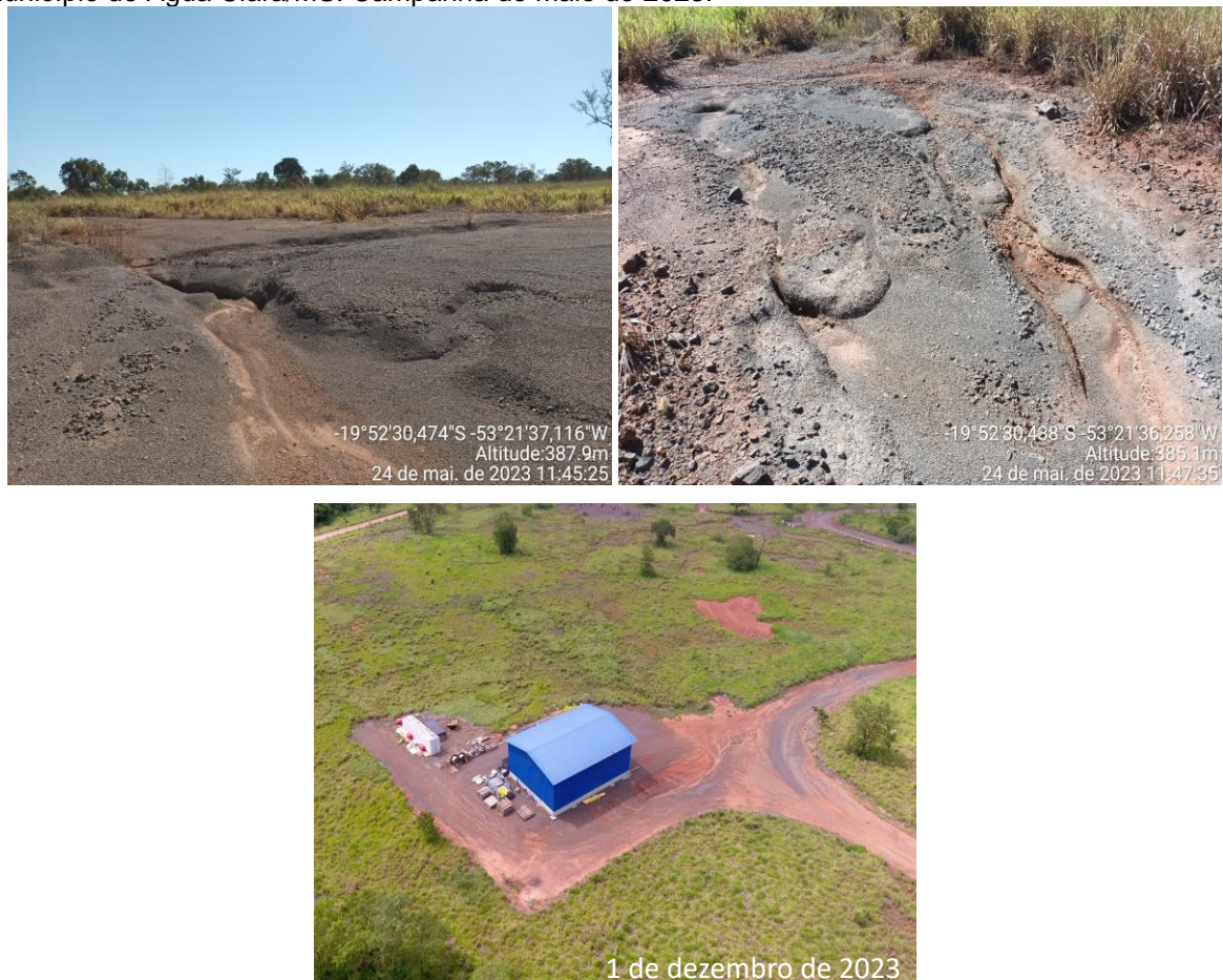
Figura 4 – Ponto 2: Erosão em sulco próximo ao almoxarifado da usina, área 1 da PCH Verde 4A no município de Água Clara/MS. Campanha de maio de 2023.
